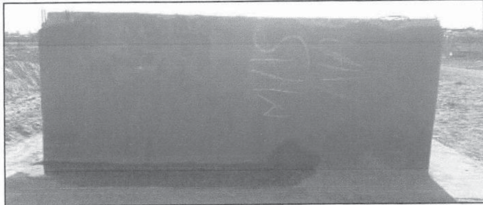
IMAGEN N° 4 FILTRACIONES DE AGUA EN MURO (PARTE INFERIOR)
